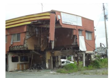
津波の被害が生々しい富岡駅前。
