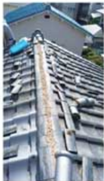
地震でずれた屋根瓦
